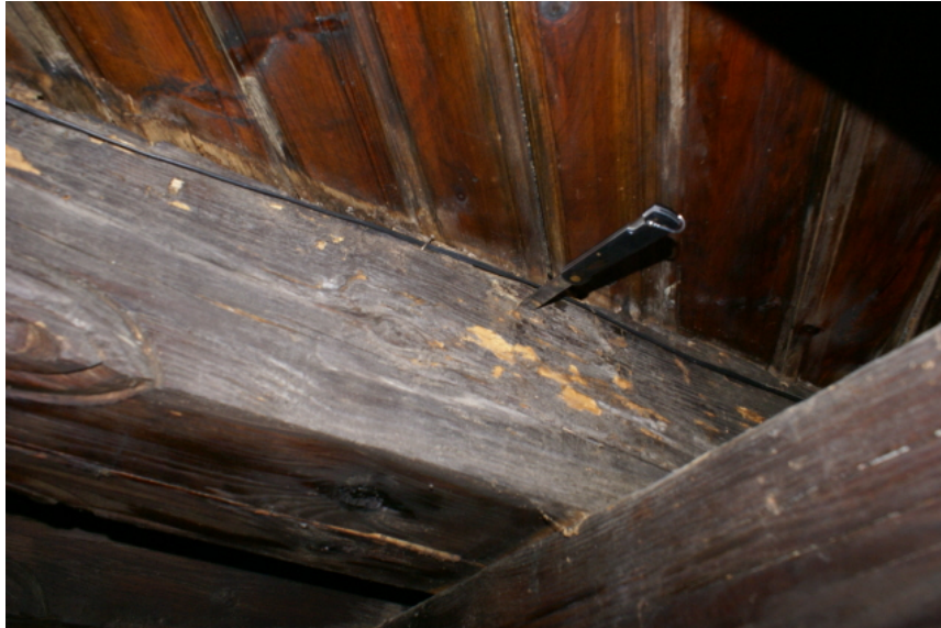
Fot. 19. Drewno w belce jest miękkie, podane na wbijanie noża, co świadczy o zaawansowanej jego korozji biologicznej
