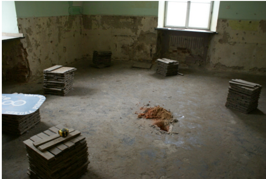
Fot. 11. Parter pałacu. Pomieszczenie w południowo-wschodnim narożniku. Widoczne zdemontowane deszczulki z posadzki, a na ścianach ślady po okładzinie boazerijnej i uszkodzenia tynku nad posadzka spowodowane zawilgoceniem i wysoleniami
