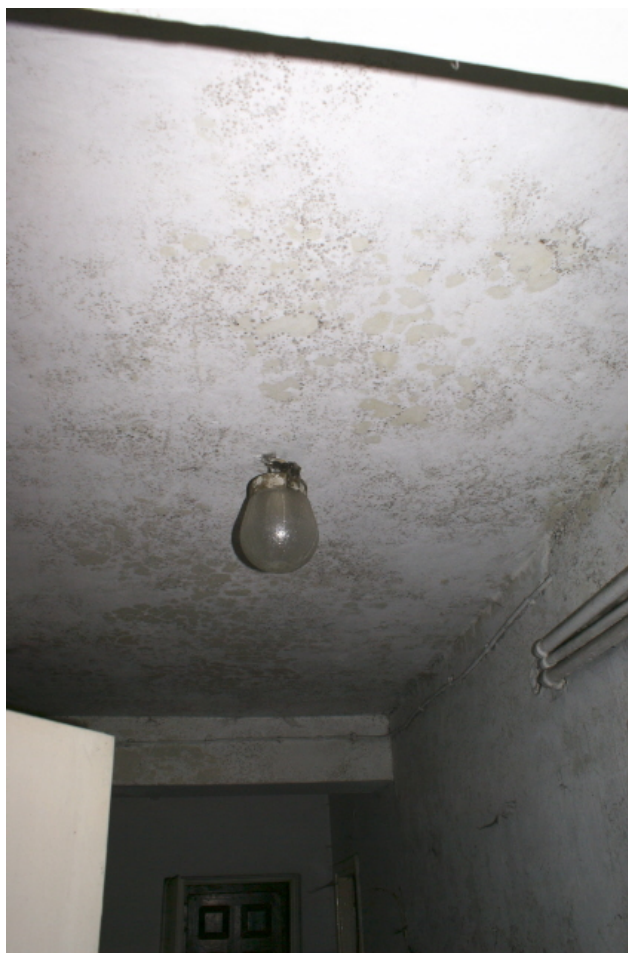
Fot. 16. Ślady porażenia grzybem-pleśnią w pomieszczeniach dawnej kuchni
