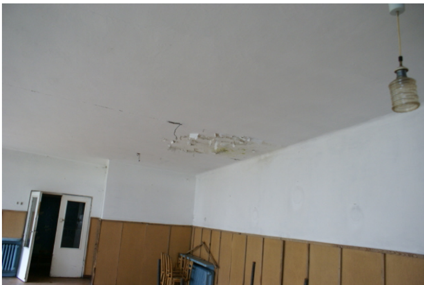
Fot. 19. Ślady przecieków przez stropodach nad pomieszczeniem stołówki.
