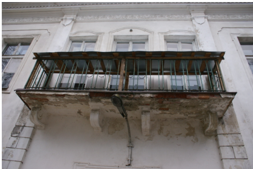
Fot. 6. Balkon nad wejściem głównym do pałacu. Jego konstrukcję stanowi płyta Kleina oparta na 4 dwuteownikach zakotwionych w ścianie pałacu. Pod płytą widać pozorne wsporniki kamienne
