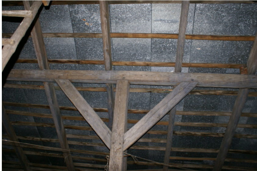
Fot. 8. W górnej części więźby dachowej, oparcie krokwi na płatwi nie pokrywa się z podparciem przez słupki i miecze, co świadczy o niechlujnie wykonanym remoncie konstrukcji dachu
