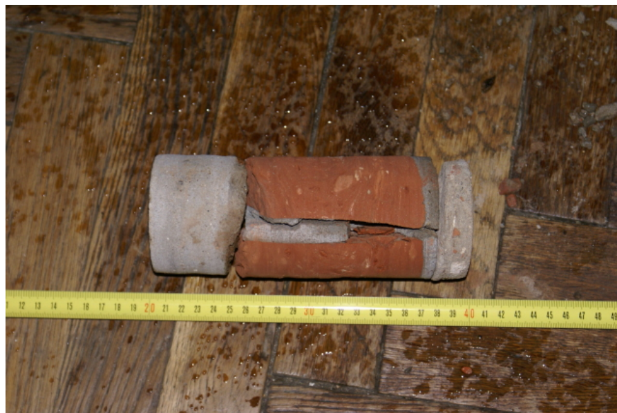
Fot. 21. Rdzeń wycięty ze stropu nad pierwszym piętrem. Płyta konstrukcyjna stropu jest płytą Kleina typu ciężkiego
