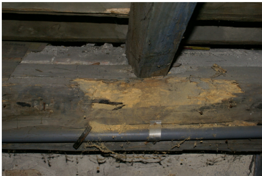
Fot. 10. Fragment murlaty porażonej korozją biologiczną
