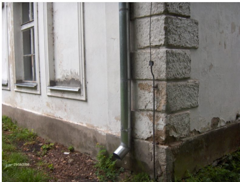
Fot. 7. Woda opadowa jest zrzucana rurami spustowymi praktycznie bezpośrednio na ściany pałacu
