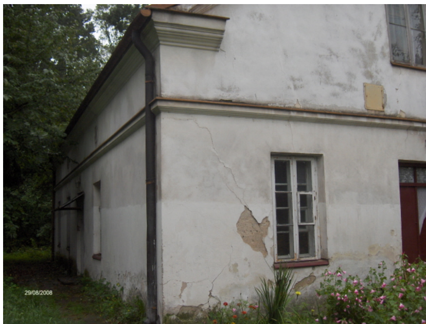
Fot. 6. Zarysowania na elewacji północnej
