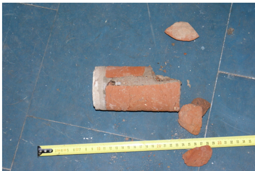
Fot. 21. Rdzeń wycięty ze stropu na parterem w budynku spichrza. Grubość warstwy cegieł wynosząca 12 cm, wskazuje na płytę Kleina typu ciężkiego
