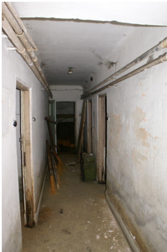
Fot. 12. Korytarz w piwnicy pod dobudowaną stolówką. Widoczne uszkodzenie korozyjne ościeżnic.
