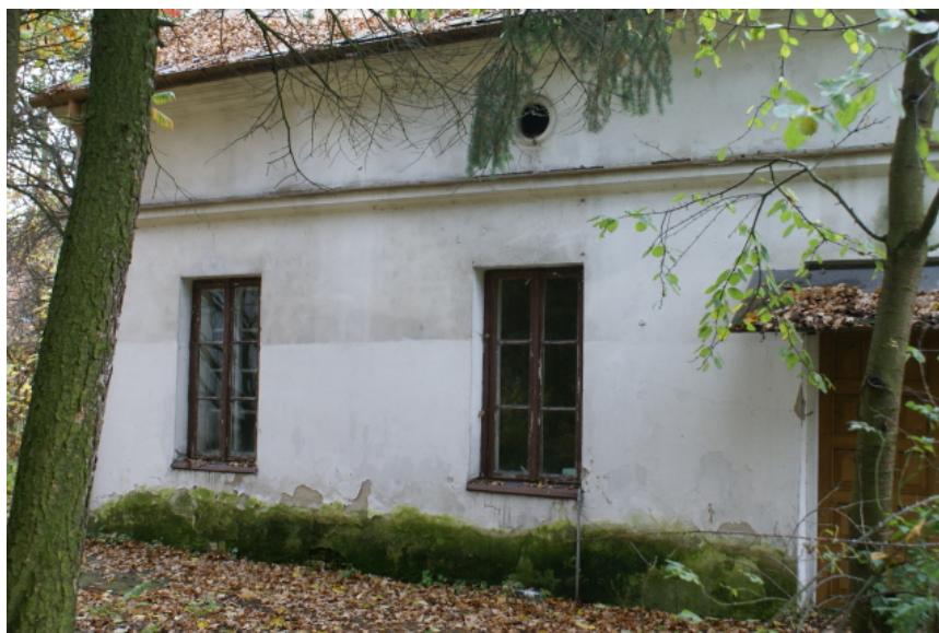
Fot. 3. Elewacja wschodnia budynku administracyjnego. Widoczny cokół z uszkodzonym przez zawilgocenie, wysolenia i korozyjne oddziaływanie glonów, tynkiem
