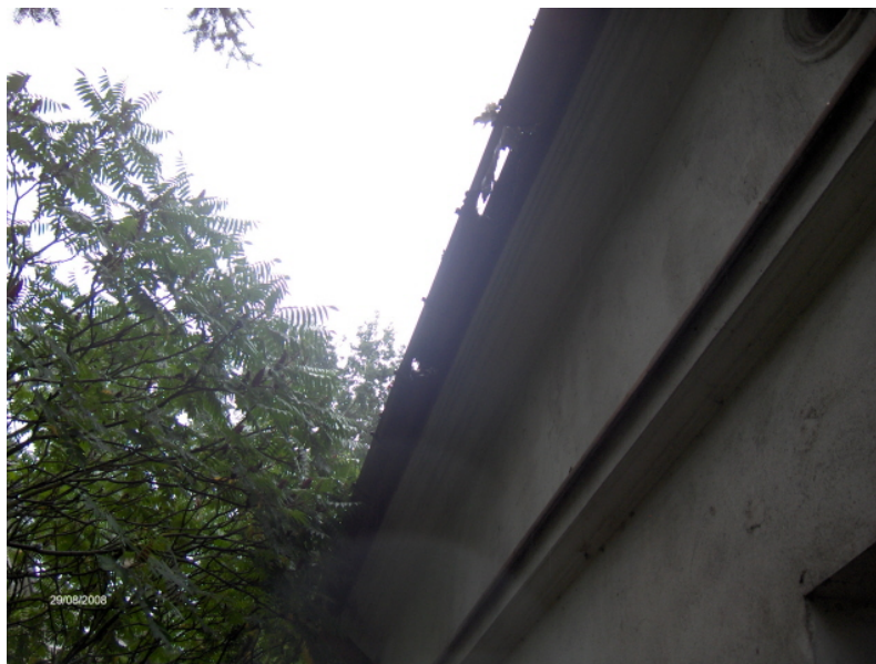
Fot. 4. Dziurawe, skorodowane rynny są przyczyną intensywnego nawilgacania wodami rozbryzgowymi części cokołowej na elewacji wschodniej budynku
