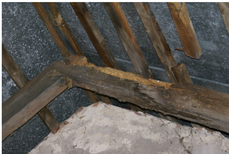
Fot. 9. Fragment krokwi porażony korozją biologiczną
