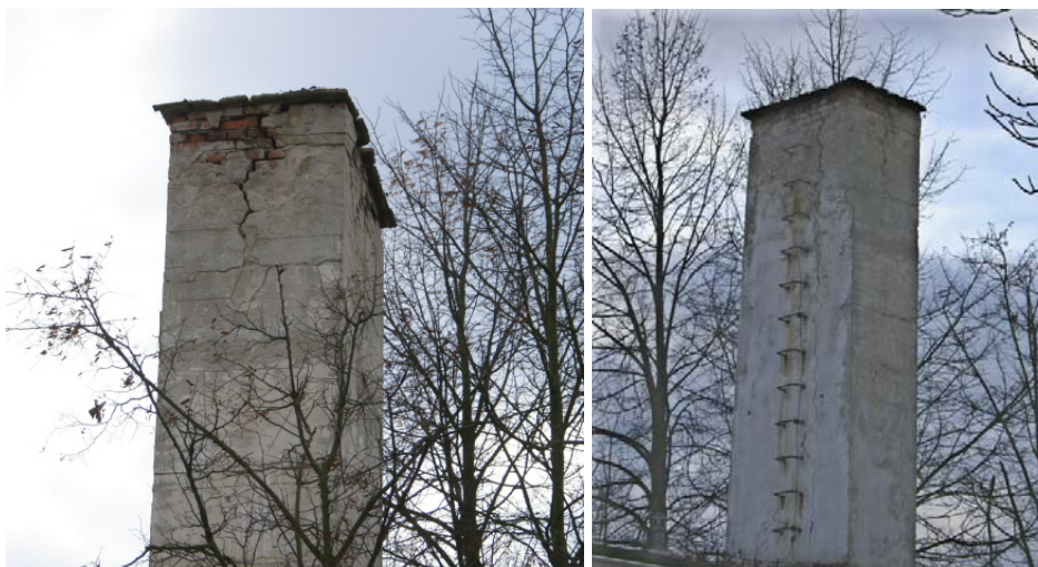
Fot. 10. Górna część komina ma spękania i jest w stanie awaryjnym
