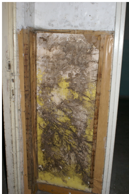
Fot. 17. Postać przetrwalnikowa sznurów grzybni pod zerwaną okładziną ściany korytarza w budynku spichrza
