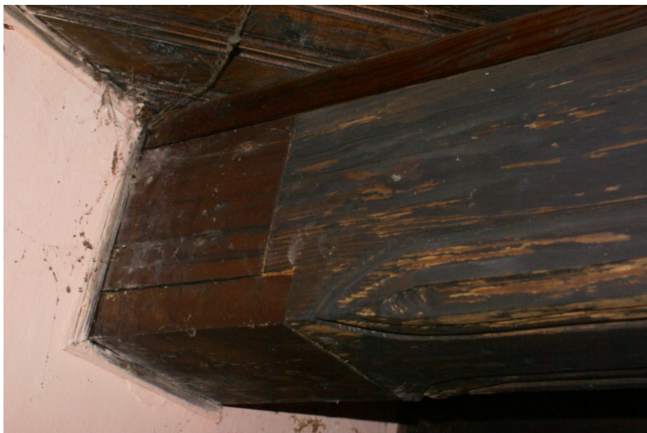
Fot. 17. Naprawa drewnianej belki polegająca na wymianie jej końcówki wykonana w sposób, który nie zapewnia zachowania nośności przekroju (zbyt mały przekrój nadbitek)
