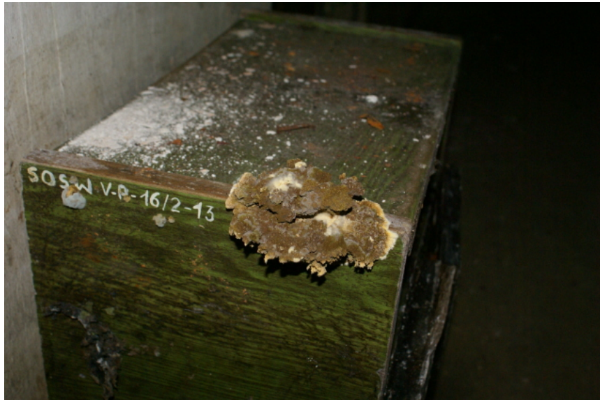
Fot. 13. Owocnik grzyba domowego właściwego na jednej z szafek w piwnicy
