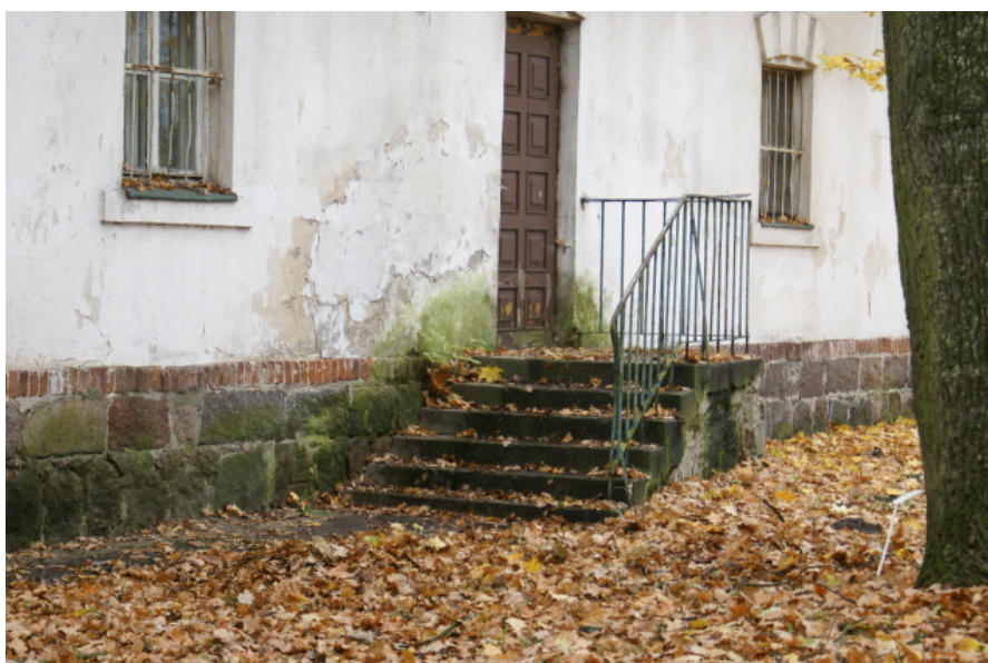
Fot. 4. Zawilgocenie przy wejściu do spichrza na elewacji wschodniej
