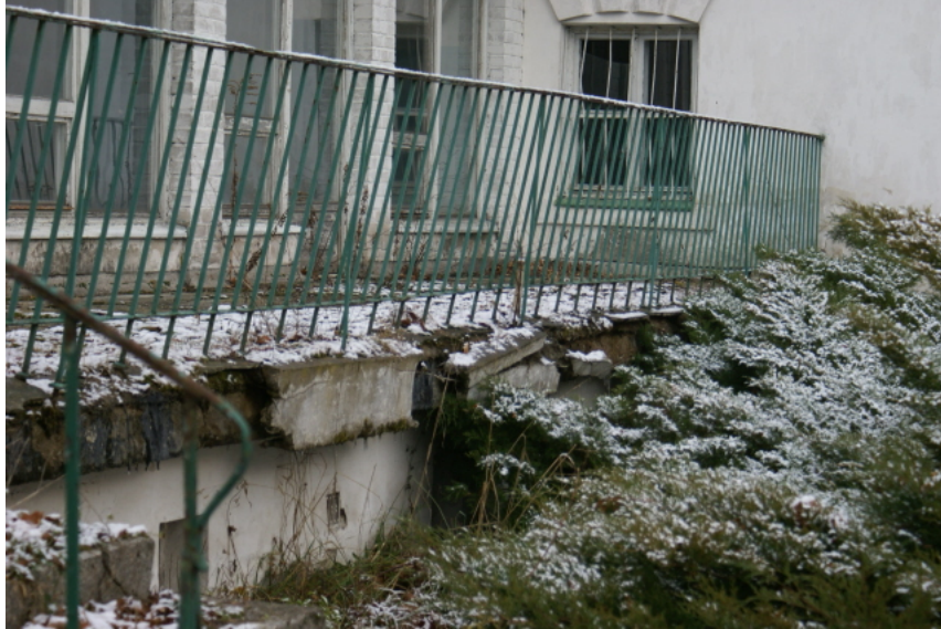
Fot. 7. Stan tarasu przy dobudowanej stolówce, na elewacji południowej
