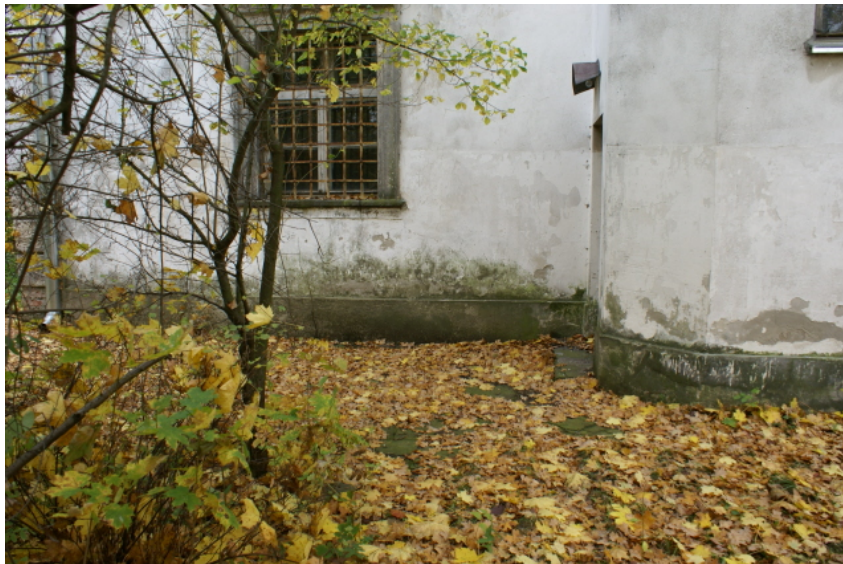
Fot. 5. Elewacja zachodnia uszkodzenia tynku spowodowane zawilgoceniem i ślady porażenia glonami
