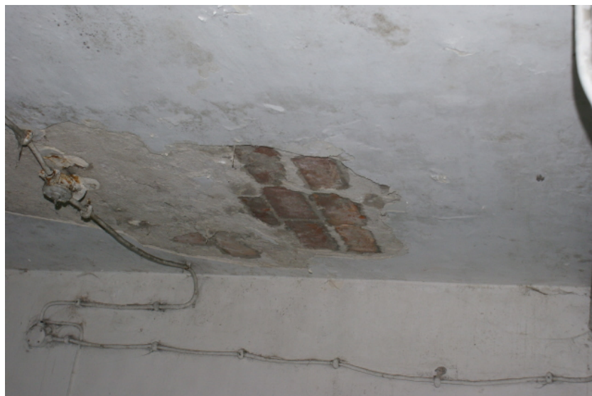
Fot. 20. Odspojenie tynku na suficie nad parterem. W miejscu odspojenia widoczny jest układ cegieł – ułożenie na „plask” - charakterystyczny dla płyty Kleina typu lekkiego
