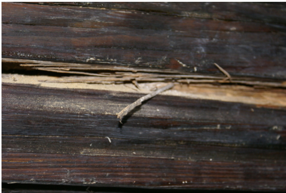
Fot. 24. W pęknięciu skrajnej belki widoczny jasny, pylasty rozkład drewna, który nie jest spowodowany żerowaniem owadów (brak otworów larwalnych)
